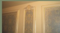
Vista de pintura mural com partes restauradas e repintadas em estêncil.
