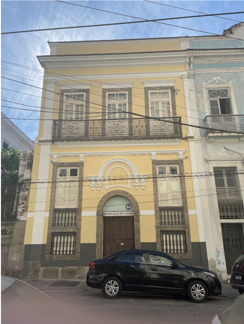
Fachada neoclássica - tratamento das alvenarias, decoração em estuque e cercaduras em gnaisse
